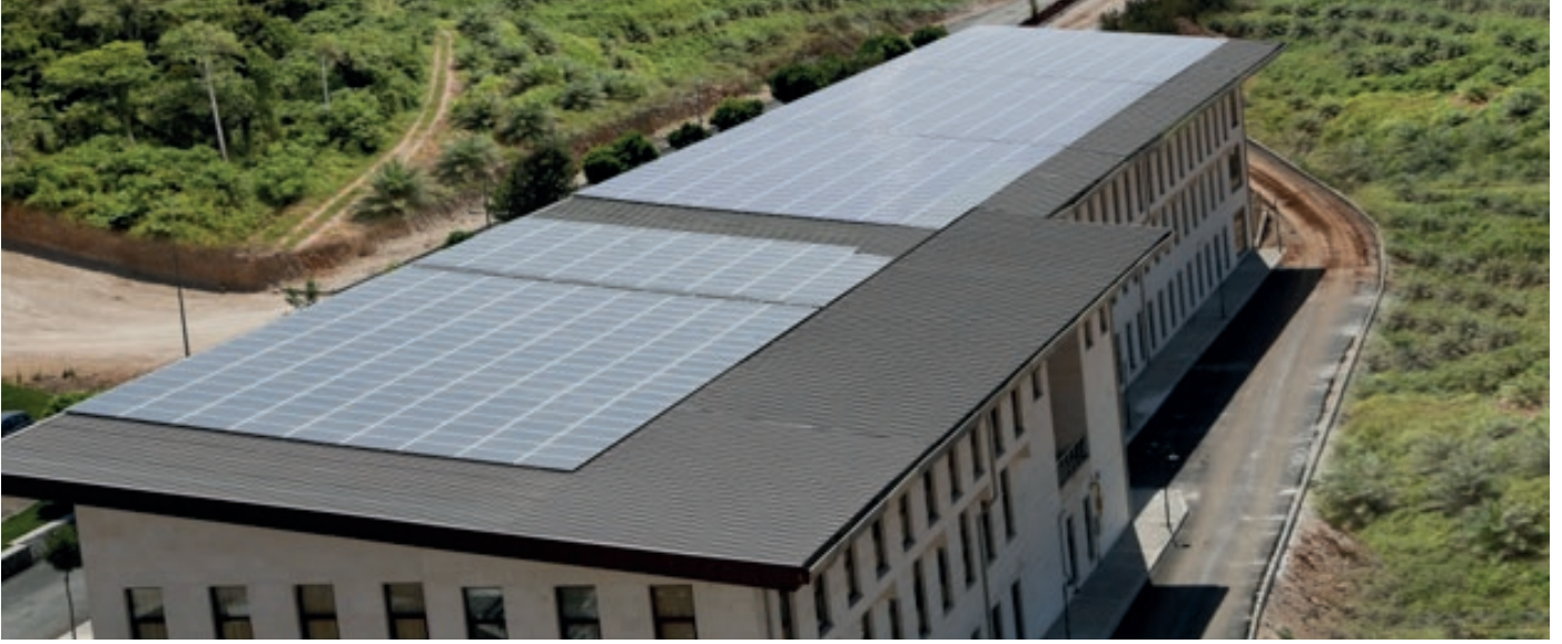
Hasan Kalyoncu Üniversitesi Güneş Enerjisi Santrali
